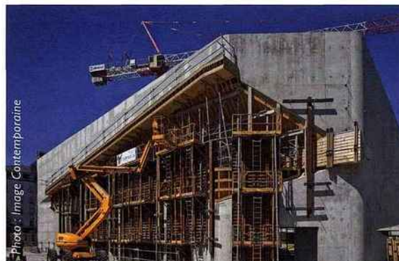
▼ Pour concevoir ce bâtiment de grande hauteur en béton brut et très structurel, environ 1 000 m 2 de coffrages bois ont été réalisés sur mesure et en trois dimensions.
